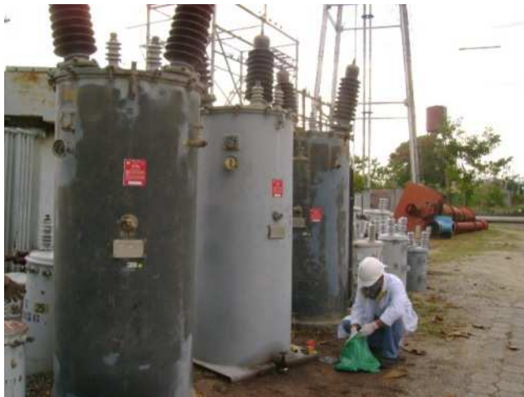
Imagen 2. Instalaciones de la Tela Railroad Company, La Lima, Cortés. Transformadores de distribución General Electric, año 1966, contaminados con PCBs. Inventario Nacional de PCBs, PNI-COPs Honduras, 2008.
