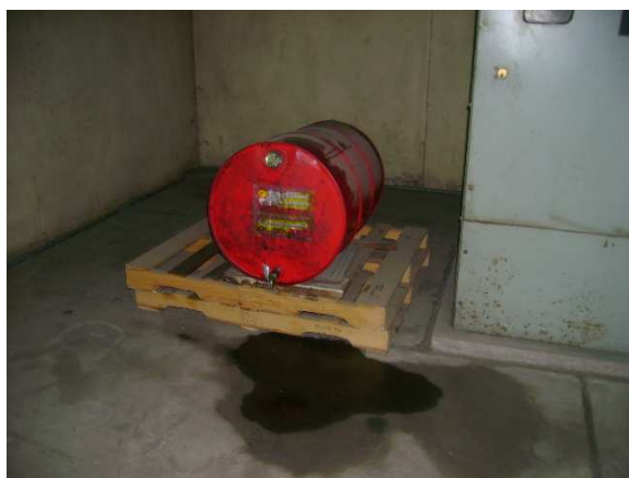
Imagen 3. Fuga en barril con aceite dieléctrico posiblemente contaminado con PCBs, ubicado en subestación del Hospital Escuela. Inventario Nacional de PCBs, PNI-COPs, Honduras 2008.
