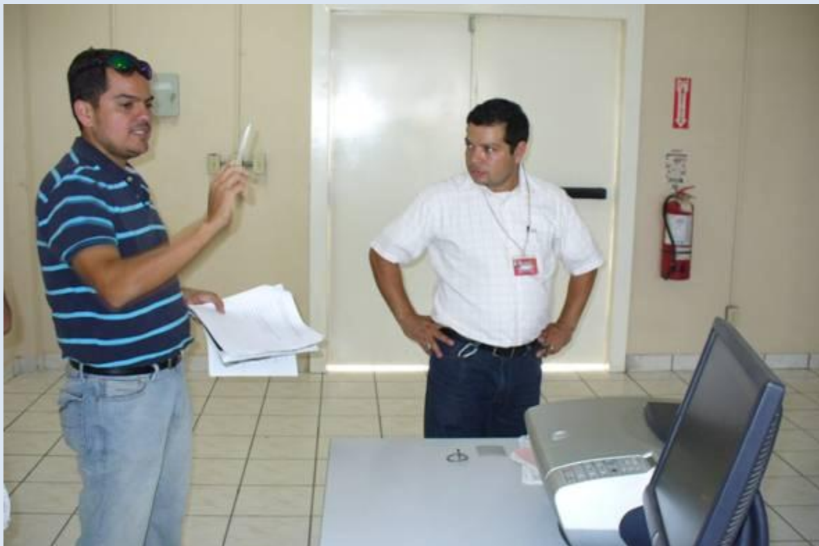
Impartiendo Capacitacion Sobre Operaci3n De Subestacion San Perdo Sula Sur. Instructores: Jose Alberto Acevedo y Denis Alberto Rubio
