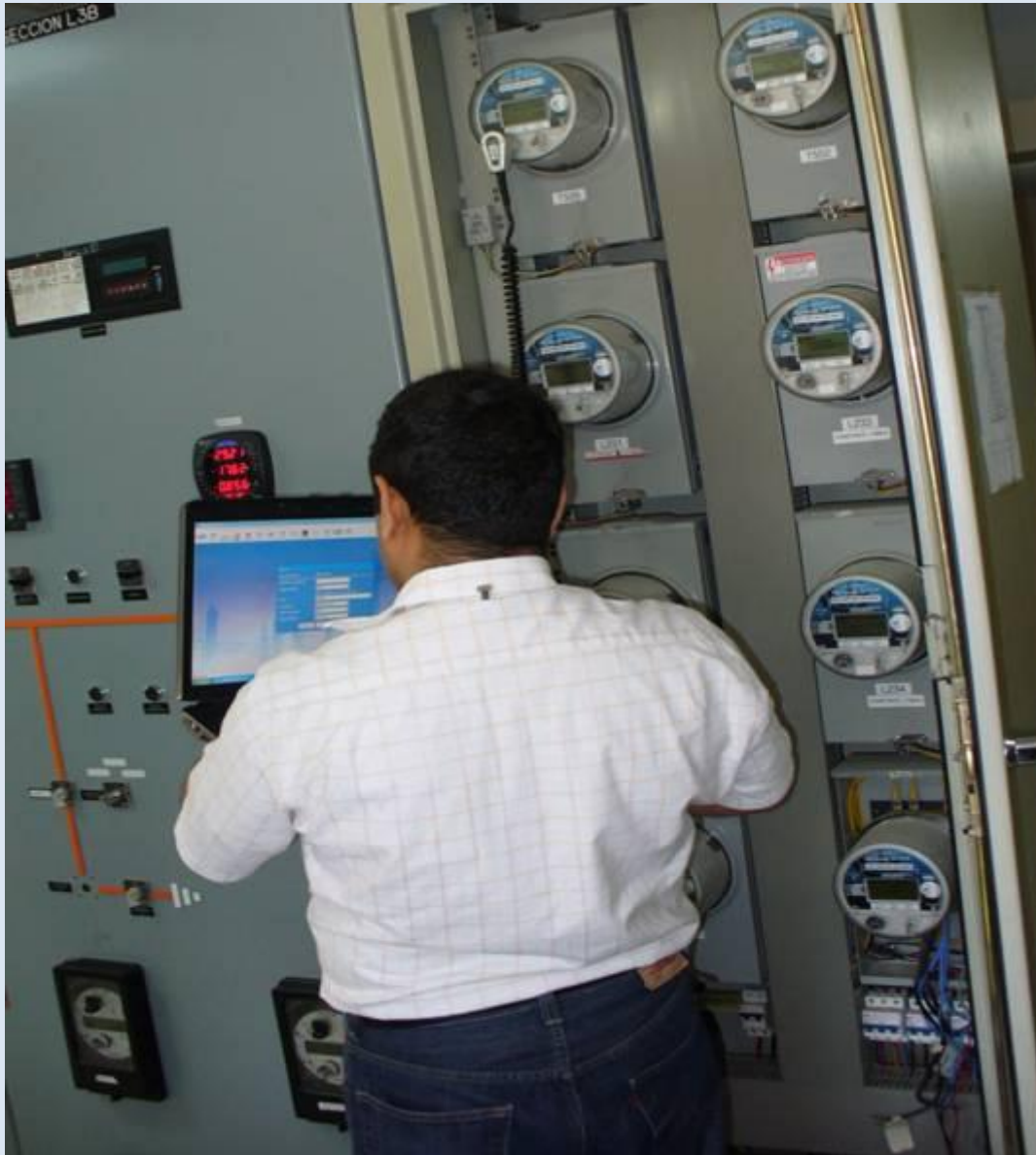
Impartiendo modulo de capacitacion sobre medidores de energia Nexus 1272 Denis Alberto Rubio
